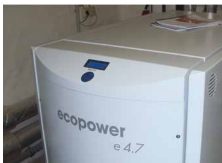
Eines der neuen BHKWs im Kloster
