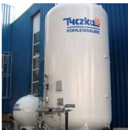
CARBOTWIN™-Anlage für die kontinuierliche Versorgung mit flüssigem CO 2 auf 50 - 60 bar
